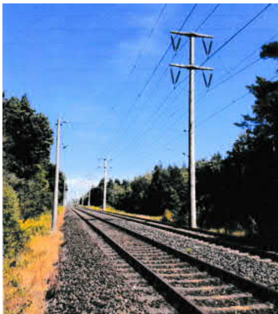
Bahnstrecke bei Lauf / Nürnberg 2x 15 kV Bahnstrom (links, rechts unten) und 2x 110 kV Stromtrasse (oben rechts)
