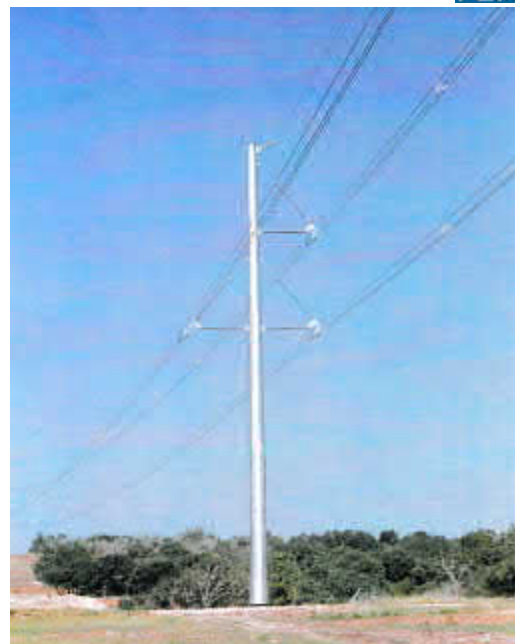
Vollwandmasten in den USA (Stahl, Beton)
